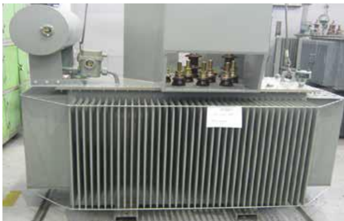
Slika br 5. Izgled transformatora 10/0,4 kV,630 KVA
